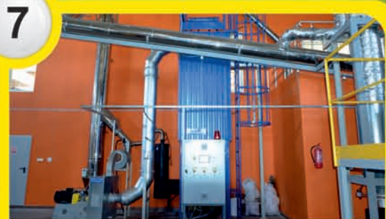
7 Reaktor spalin ze stacją podawania sorbalitu oraz kolumna z filtrami workowymi i wentylatorem wyciągowym spalin
