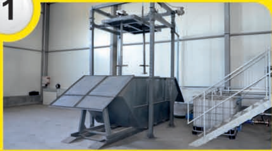
1 Przygotowanie polielektrolitu i osadów do odwadniania oraz tłoczenia ich pompą osadowa do prasy filtracyjnej
